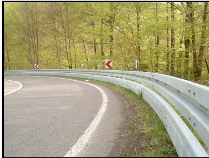
Sicherheit durch Unterfahrschutz an der L 108
