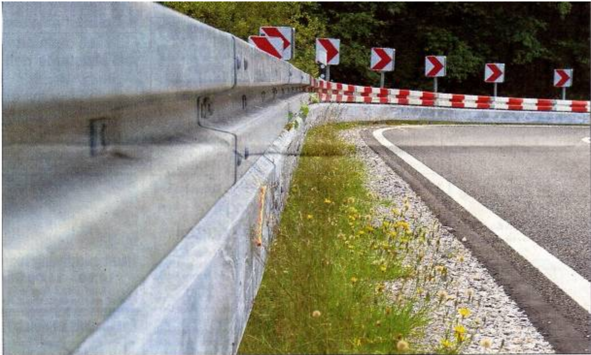
Der Unterfahrschutz an den Schutzplanken gibt den Zweiradfahrern mehr Sicherheit.
