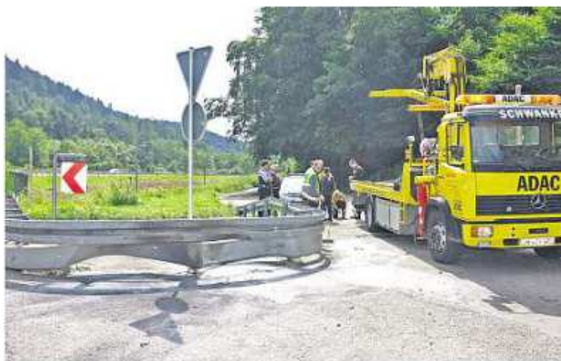
Schutz bis zum Boden: Hier stürzte ein junger Motorradfahrer in die Metallplanken, die 2008 eingebaut wurden und mehr Sicherheit bieten sollen. FOTO: TILO KELLER
