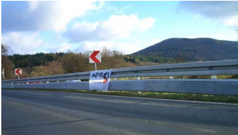
Sicherheit durch Unterfahrschutz an der L 3382
