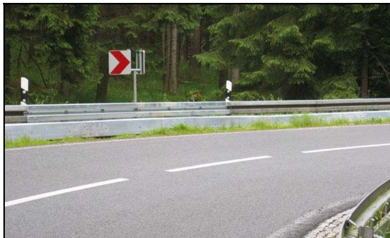
Eine der 16 Kurven mit Unterfahrschutz auf der B 81
